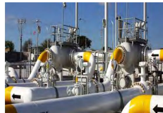
Системы контроля газопроводов
